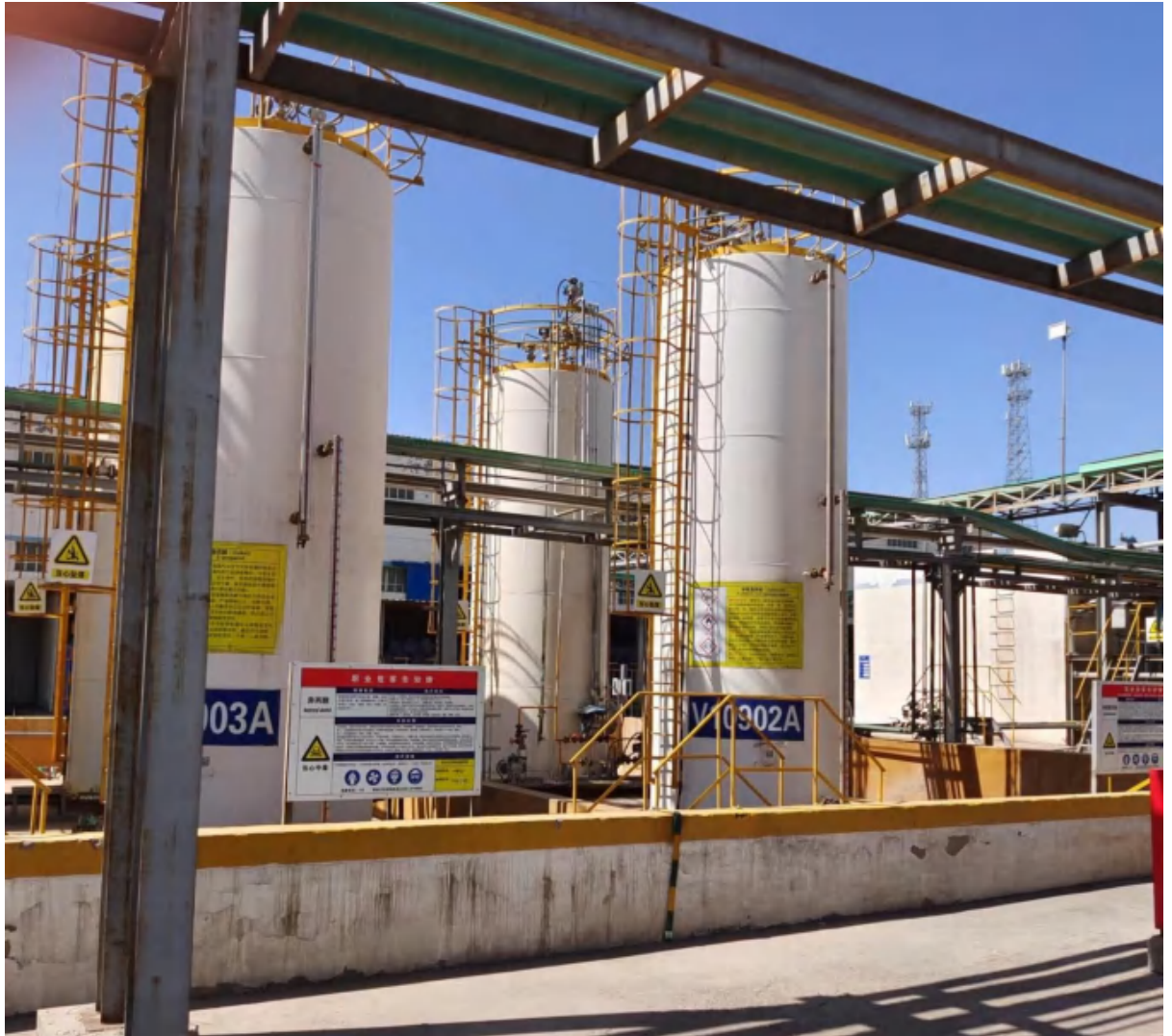
图 4.1.1-1e 环氧氯丙烷、异丙醇储罐分区围堰，罐区周围硬化
