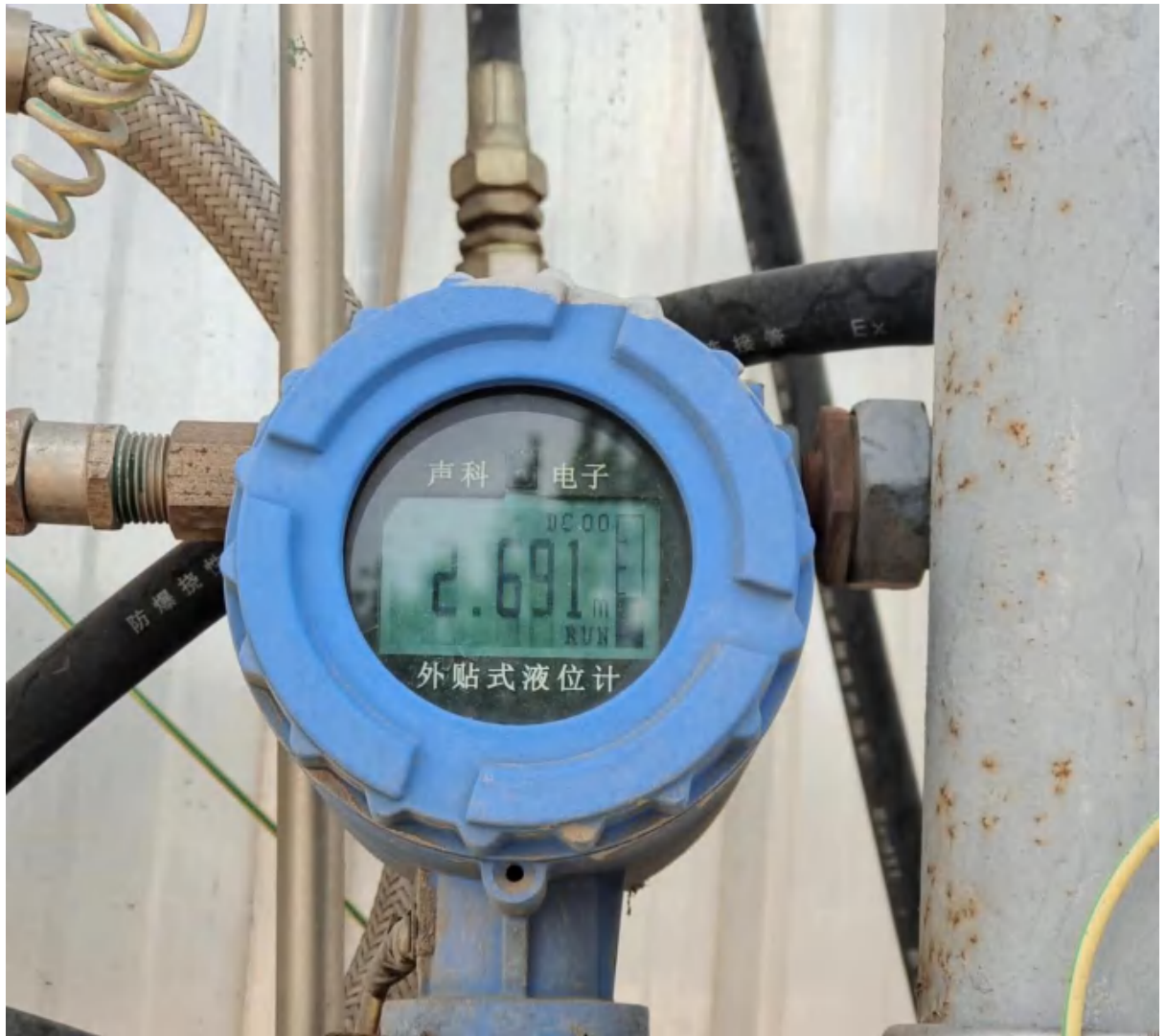
图 4.1.1-1b 储罐区外贴式液位计
