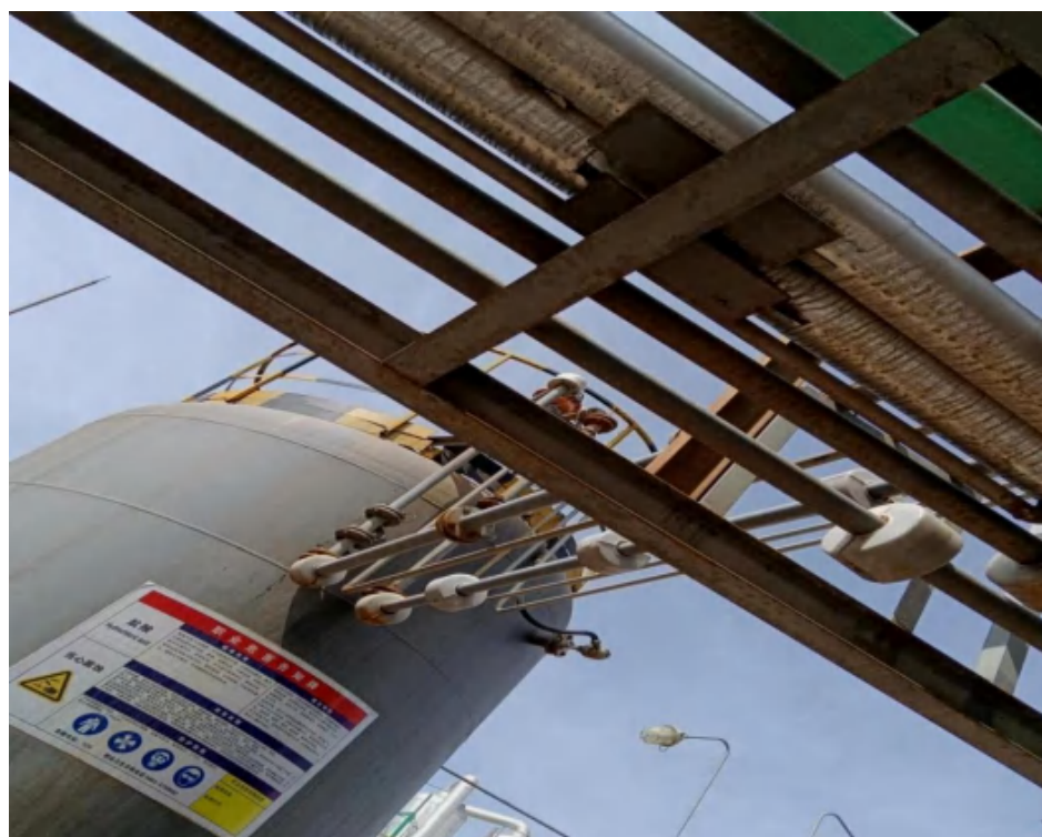
图 4.1.2-3 厂区液体输送管线
