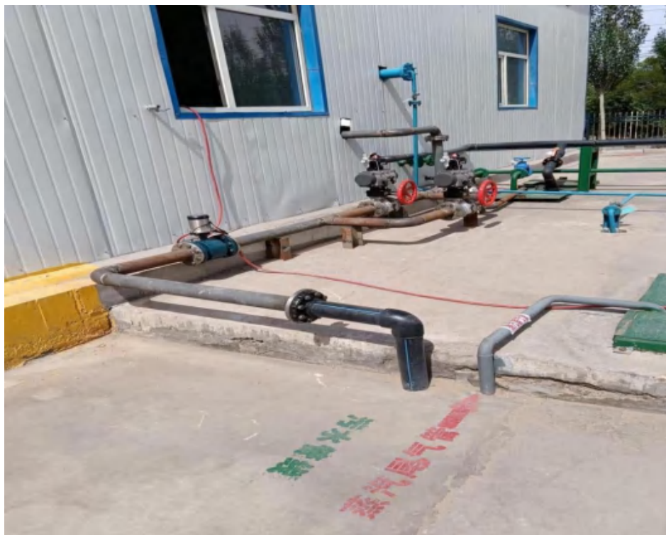
图 4.1.2-2 污水输送管线及传输泵
