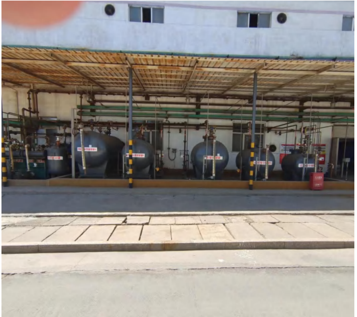
图 4.1.1-3b 二车间中间罐
