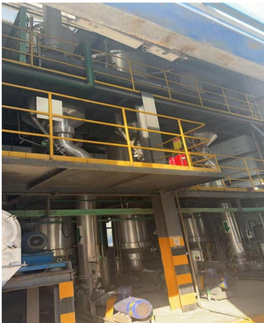
三效蒸发装置 图 4.1.5-1 污水处理区域
