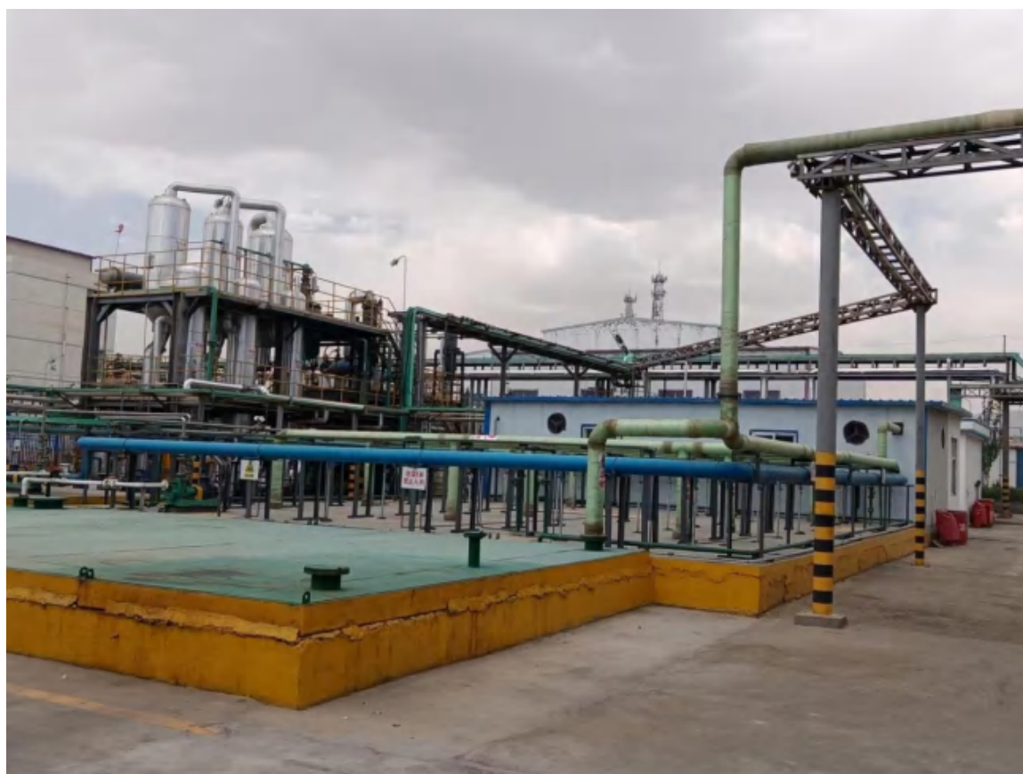
污水处理生化水池
