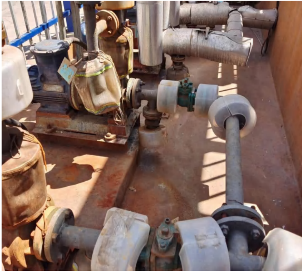
酸碱罐区酸碱输送泵
