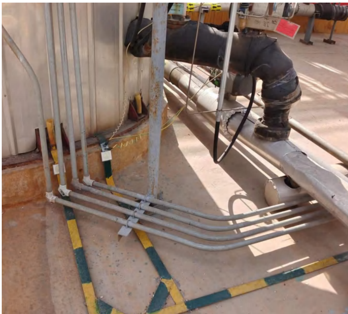
图 4.1.1-1f 罐区静电消除器
