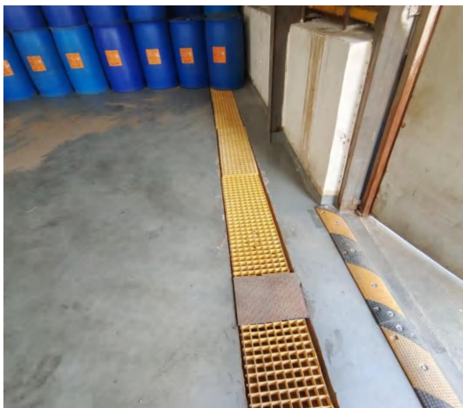
危废暂存间导流槽
