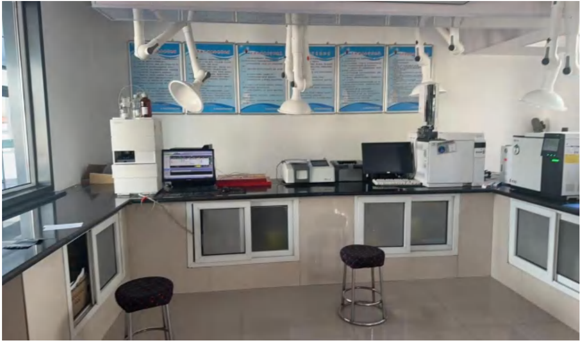
分析化验室废气收集装置
