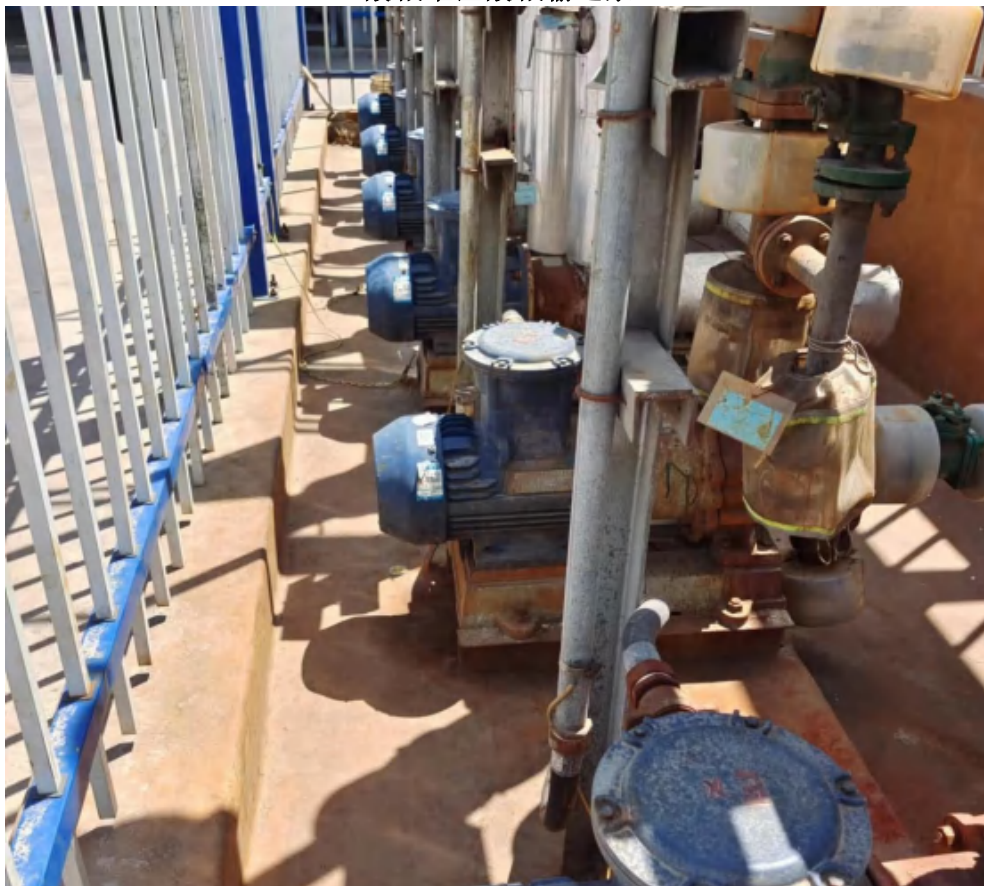
酸碱罐区酸碱输送泵设置围堰、接收集桶 图 4.1.2-5 传输泵
