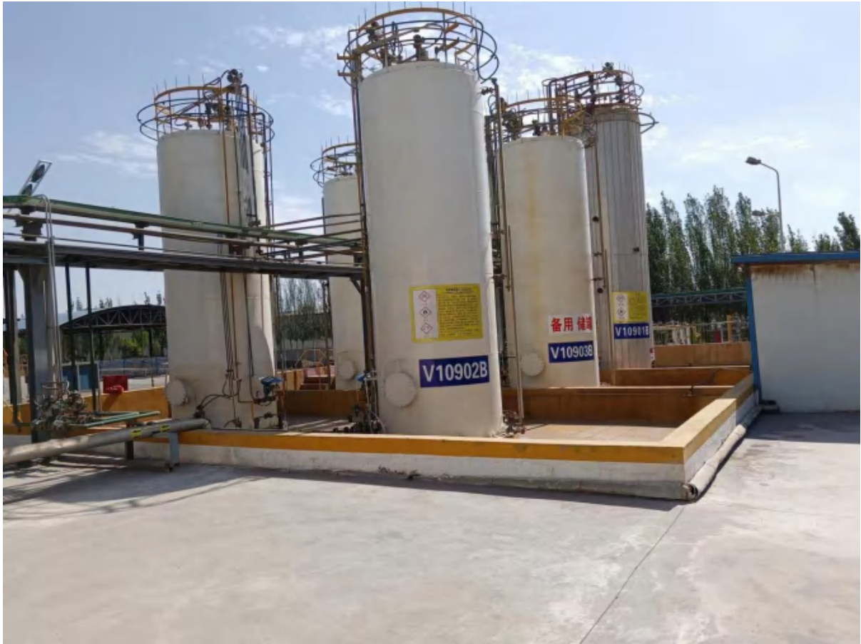
图 4.1.1-1c 储罐区、围堰、输送管线
