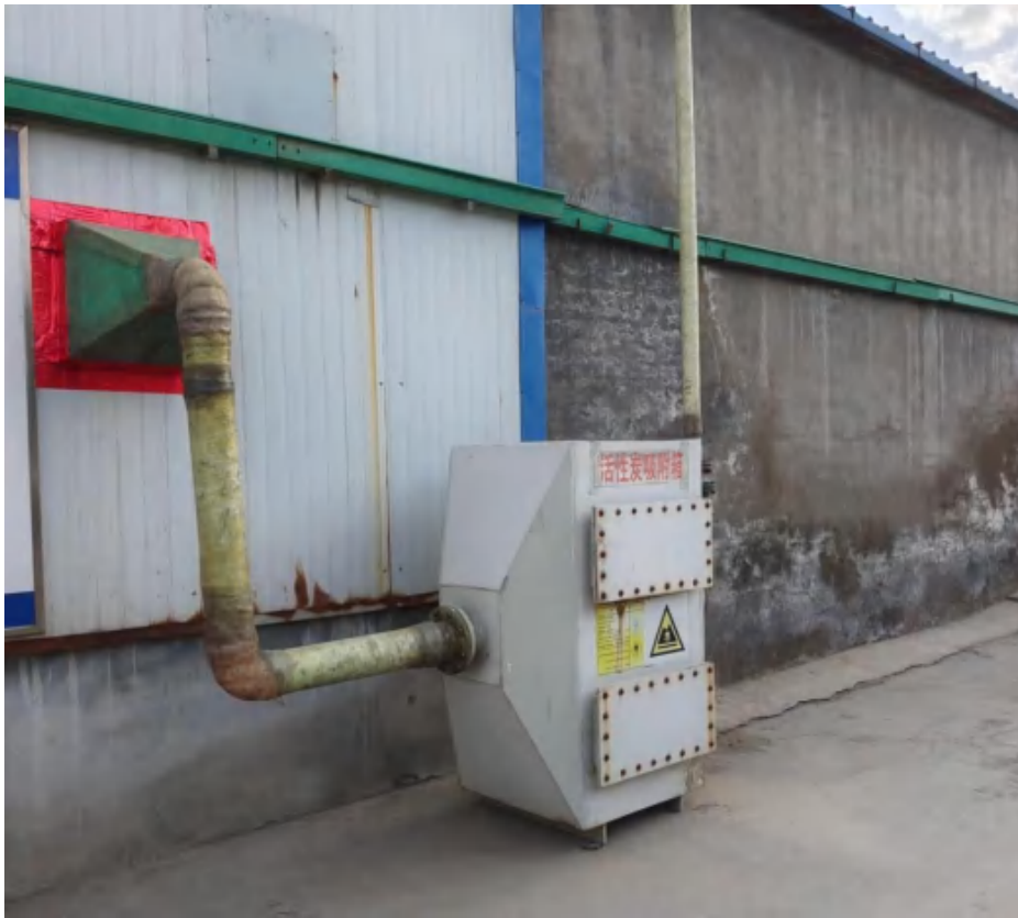
危废暂存间尾气处理装置
